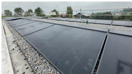
Die neue Photovoltaikanlage liefert Solarstrom für Tierheim und Betrieb – ein nachhaltiger Schritt in die Zukunft.
